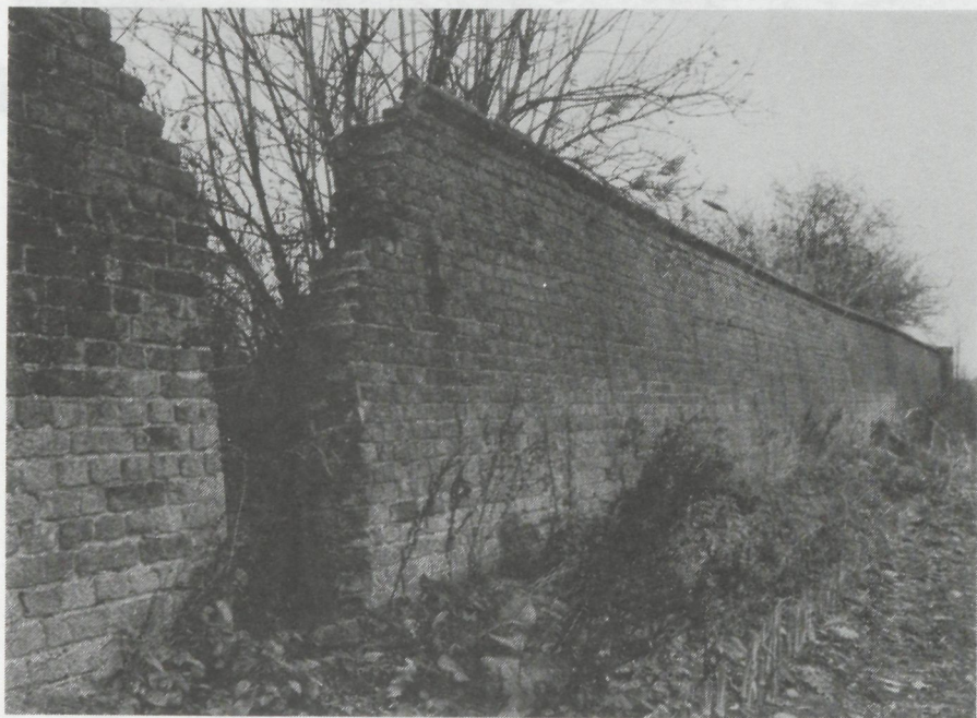
Achter de muur bij dit gat liggen nog resten van een deur.
