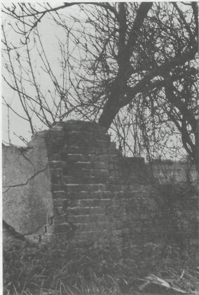
Het in zeer slechte staat verkerende restant van de zijmuur aan de kant van de Griftdijk.
