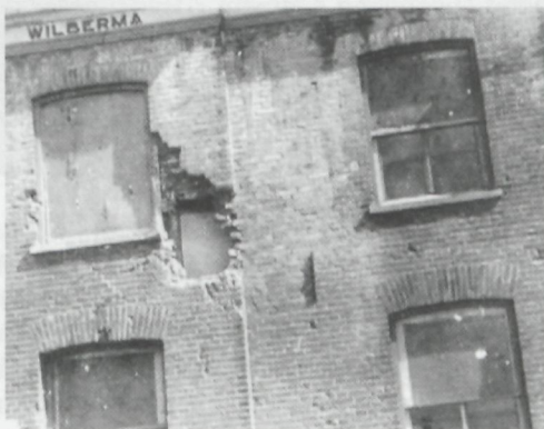
Schade aan huize 'Wilberma'.
